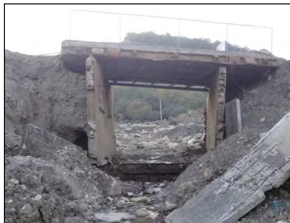
Рис.5. Разрушенный мост в результате боковой эрозии и селевого процесса в районе с. Гиляны (ООО «СтройСервис»)
